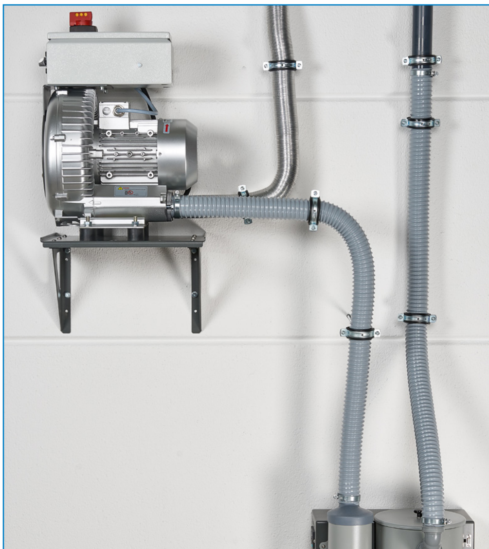
Abb. 9: Saugmaschine mit installierter Saugleitung am Einlass des Motors / Strömungsrichtung EIN
