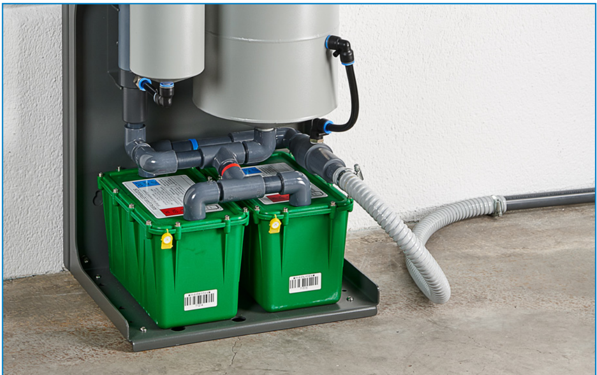
Abb. 10: Tankeinheit mit installierter Abwasserleitung
